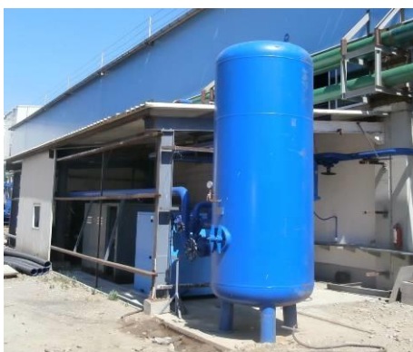
Слика 22 Компресорска станица
