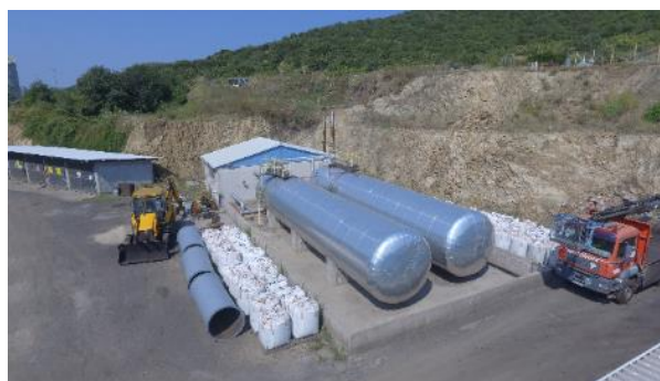
Слика 20 Котлара и мазутна потстаница
