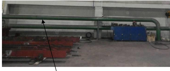
Слика 32 Цевковод за вода (погон Валавница)
