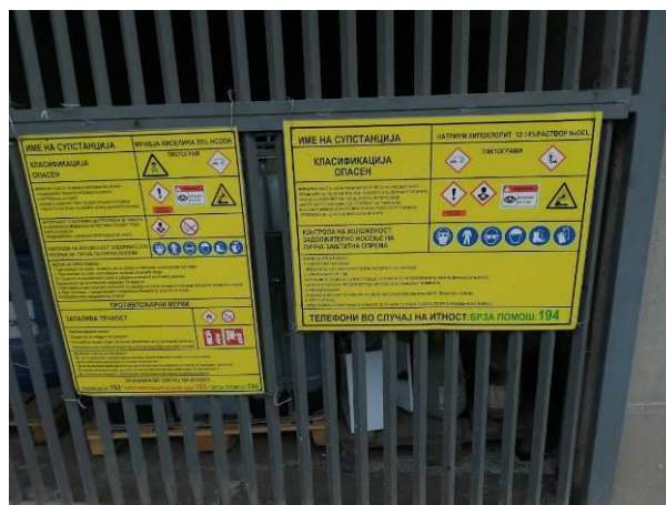
Слика 14 Магацин за складирање на NaOCl (натриум хипохлорид) и HCOOH (мравја киселина) Во друг магацински простор, кој е дел од погоре споменатиот магацински комплекс се складираат останатите садовите со хемикалии кои се користат за заштита на системот за рецикулација.
